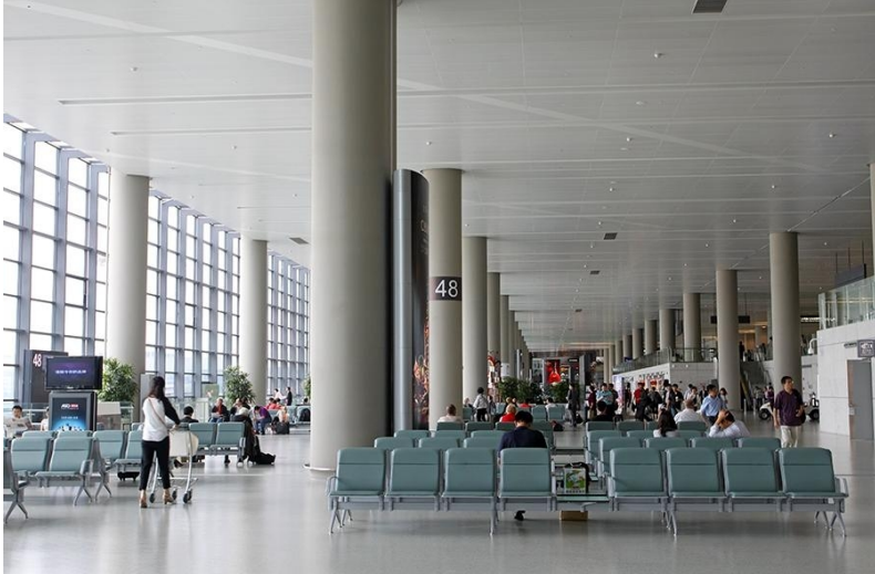
Photo 3: KNX Awards de l'efficacité énergétique: Dans le terminal de l'aéroport international Hongqiao de Shanghai, KNX contrôle l'éclairage pour optimiser l'efficacité énergétique. Le système a été mis en œuvre par la société d'installation électrique Longchuang Control Automation System Co de Shanghai.
